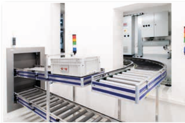
Abb. 4: Sende- und Empfangsstation mit Ausschleuse-Bahn im Erdgeschoss
