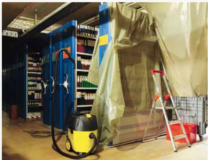
Abb. 2: Wassereinbruch am 21./22.11.2016, 1. UG, Abschnitt 3
