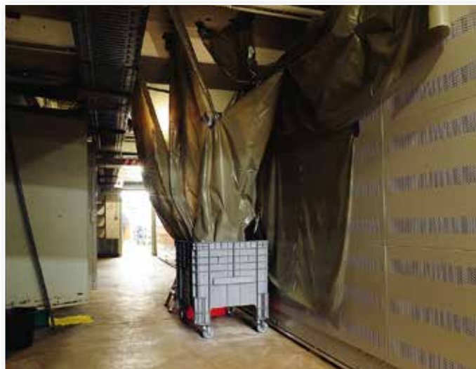
Abb. 3: Wassereinbruch am 23.12.2016, 1. UG, Abschnitt 3
