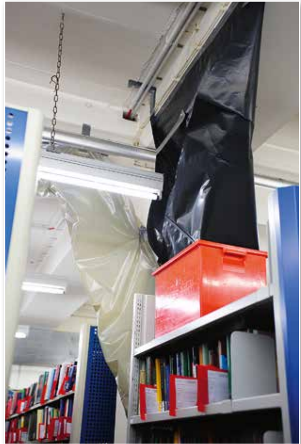
Abb. 1: Wassereintrich am 7./8.11.2016, 1. UG, Abschnitt 7
